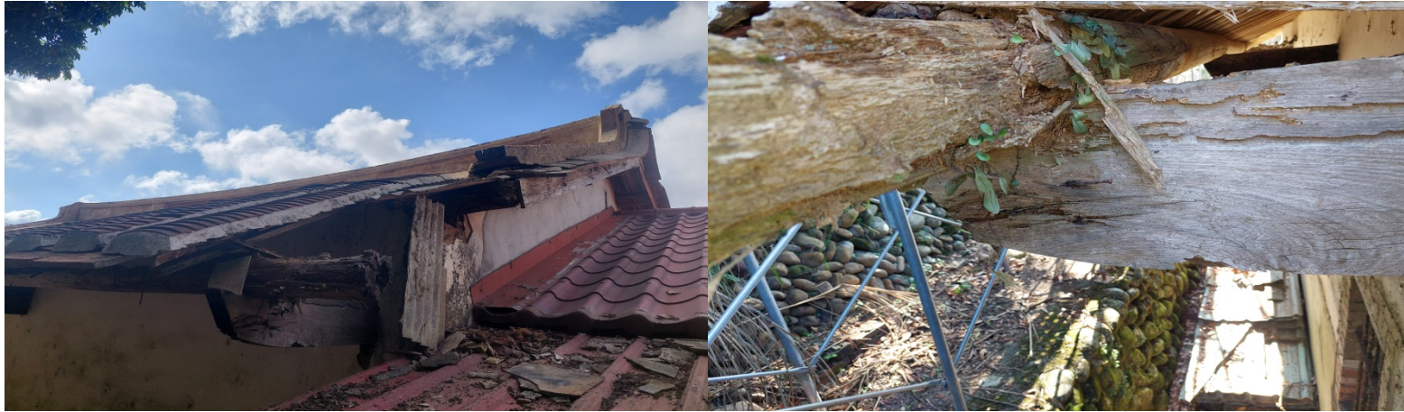
施工說明：木構架損壞情形 位置：正廳右後坡
