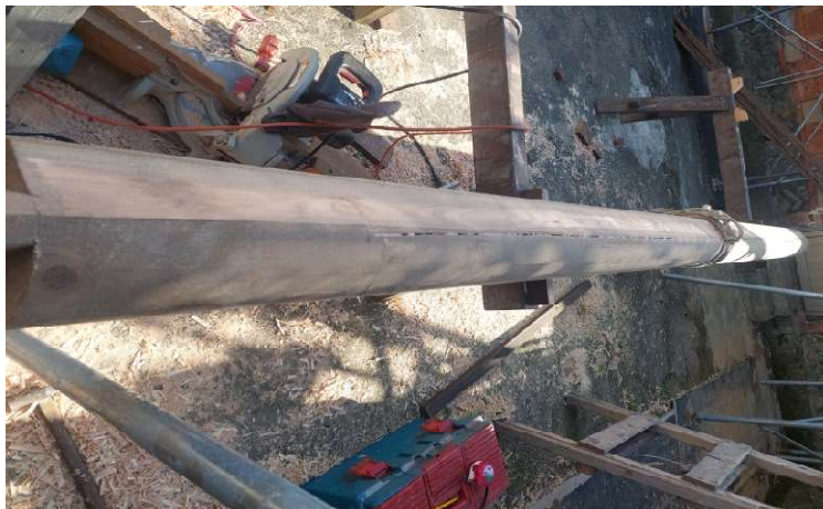
施工說明：圓桁水面加工及護木漆施作 木種：臺灣紅檜木種：臺灣紅檜
