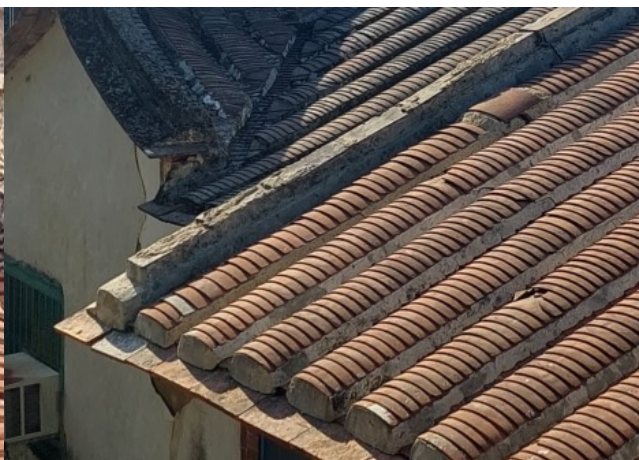
施工說明：左後坡屋面損壞情形
