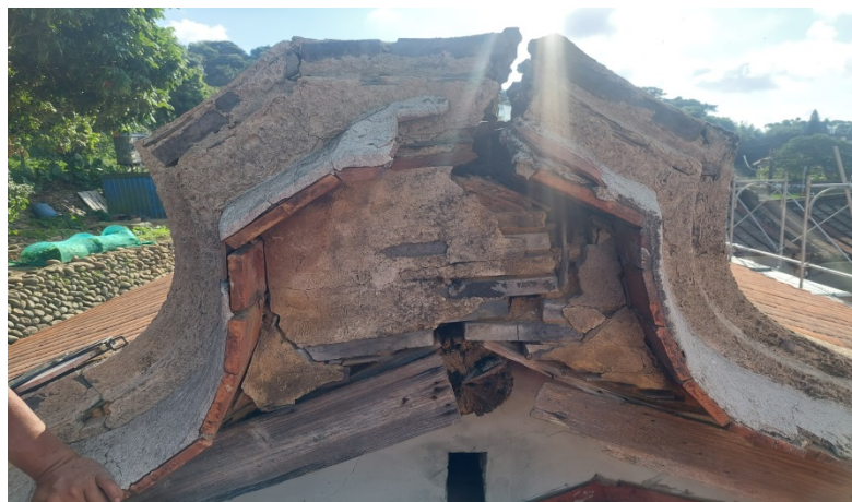
施工說明：馬背裂痕 位置：正廳右側
