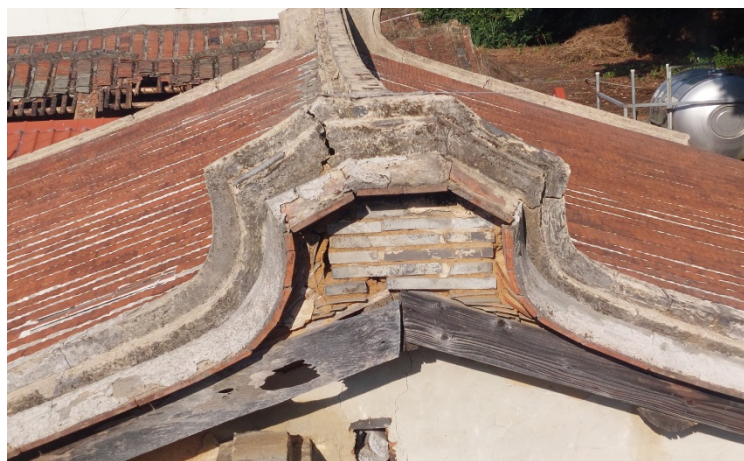
施工說明：馬背裂痕 位置：正廳左側
