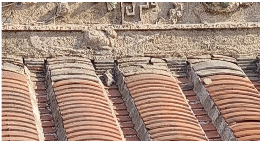
施工說明：屋面脊脚損壞情形 位置：正廳中脊位置：正廳左後坡
