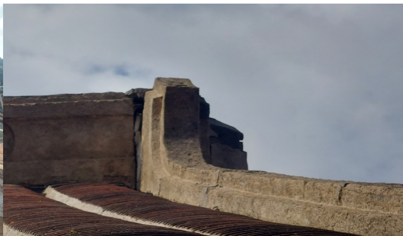
施工說明：馬背裂痕 位置：正廳右側
