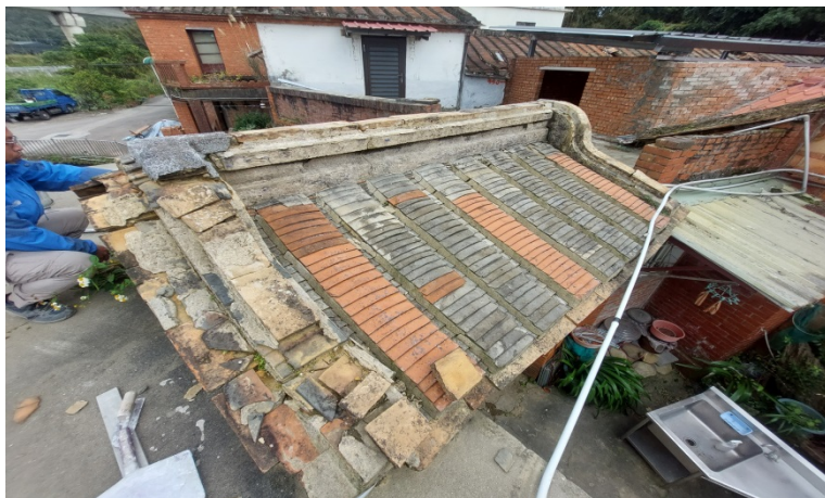
施工說明：規帶斷裂面 位置：門樓
