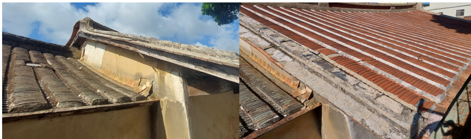
施工說明：牆面白灰粉刷風化 位置：正廳右側山牆
