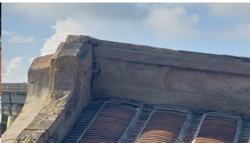
施工說明：馬背裂痕 位置：正廳左側
