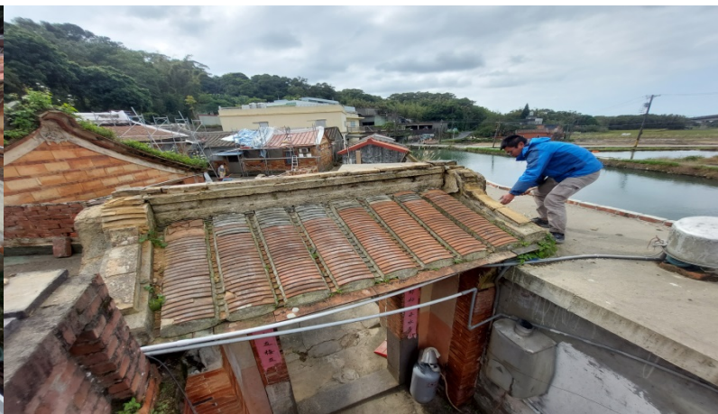
施工說明：屋面損壞情形 位置：門樓
