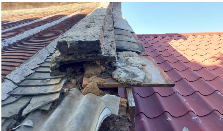
施工說明：規帶斷裂面 位置：正廳右後坡
