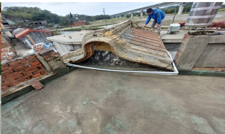
施工說明：屋面損壞情形 位置：門樓
