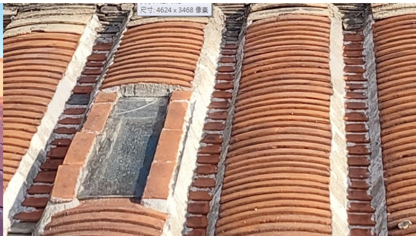
施工說明：屋面天窗損壞情形 位置：正廳前坡
