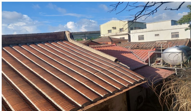
施工說明：屋面損壞情形 位置：正廳右後坡
