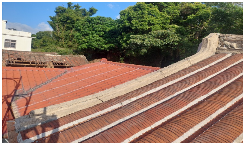
施工說明：規帶裂痕 位置：正廳右側
