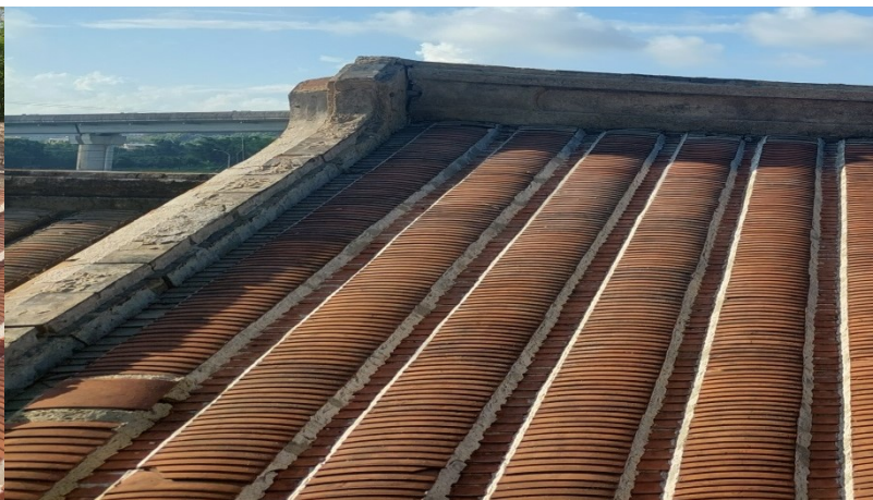
施工說明：規帶裂痕 位置：正廳左側
