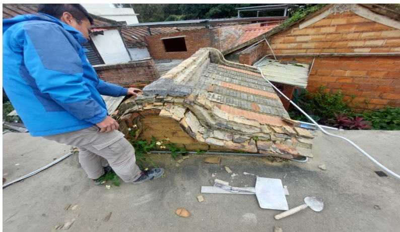
施工說明：屋面損壞情形 位置：門樓
